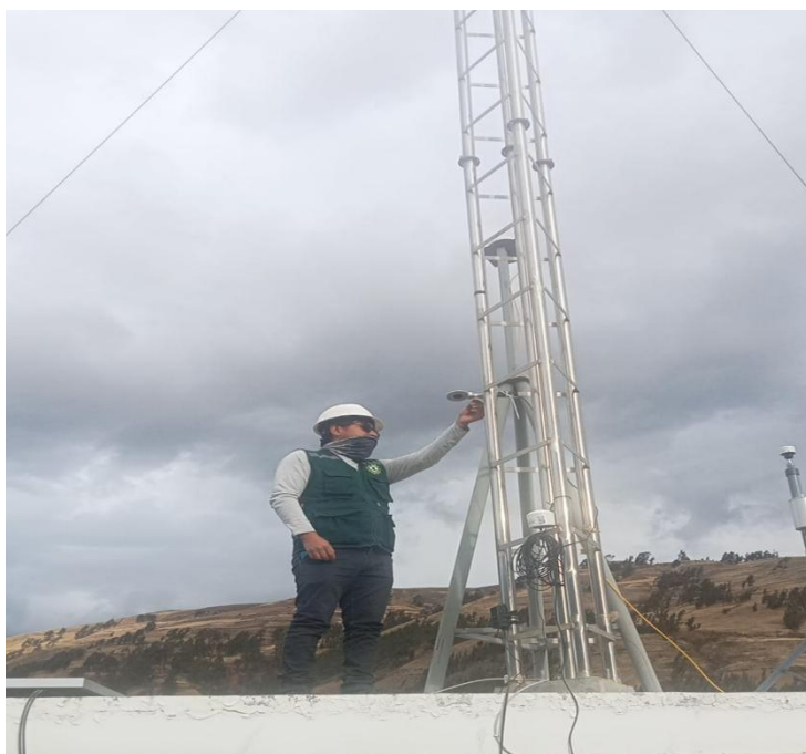
Figura 16 Instalación del sensor (Profiler Model 212)
